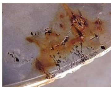
corrosion par piquûre
